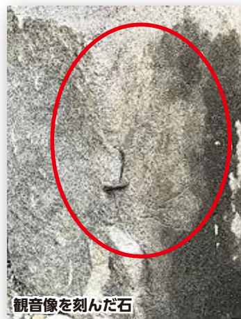
観音像を刻んだ石 今回の熊本地震によって、熊本城内にある加藤神社の石垣も大きく崩れ、観音像を刻んだ石が見つかりました。
