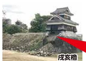
戌亥櫓 土台の石垣は内側から崩れ、隅石の一本柱が木造三階建ての櫓を支えています。
